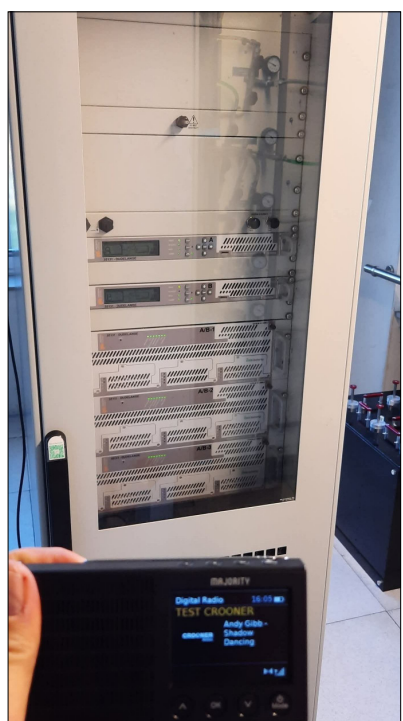
Die Sendeanlage in Dudelage mit zwei DAB+ Modulatoren und drei zusammengeschalteten Verstärkern. Ausserhalb des Schrankes befindet sich der Maskenfilter.
